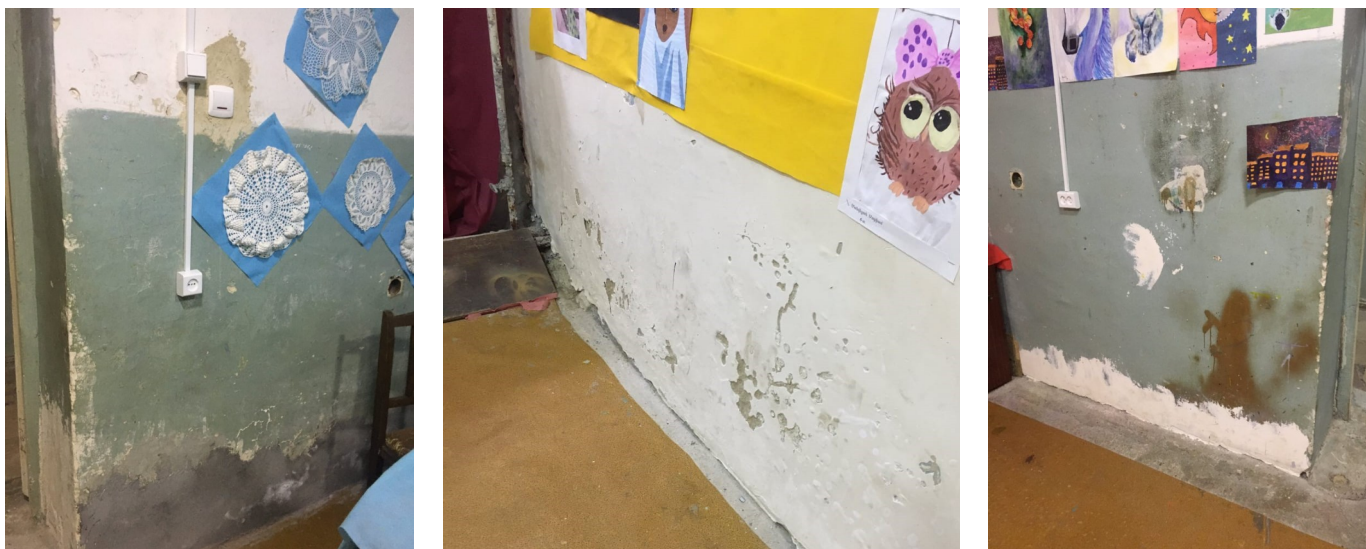
Les travaux des élèves cachant mal l'état de décrépitude des murs de l'école.
